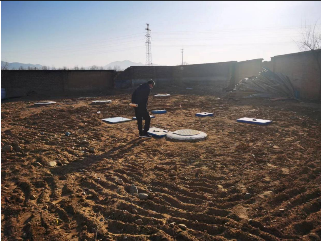
地埋式污水处理站
